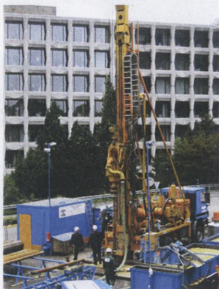
De pomp waarmee bij het ABP geboord werd. Dit kantoor kan worden aangesloten op mijnwaterenergie (voor koeling).
